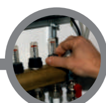
regulacja hydrauliczna instalacji ogrzewania podłogowego hydraulic adjustment of the underfloor heating system
