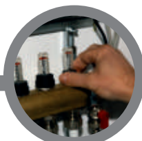
regulacja hydrauliczna instalacji ogrzewania podłogowego hydraulic adjustment of the underfloor heating system
